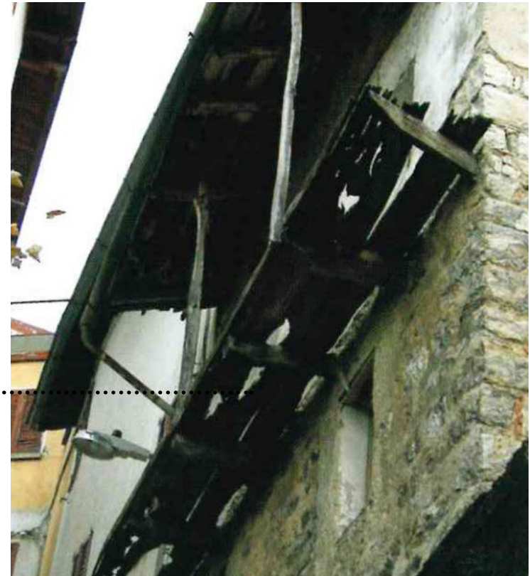
DEGRADO DI UN BALCONE LIGNEO
